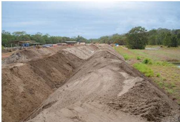
3 Le sol traité est déplacé vers des lits à revêtement afin de permettre une surveillance continue de la dégradation des hydrocarbures et de l'amélioration de la qualité du sol.
