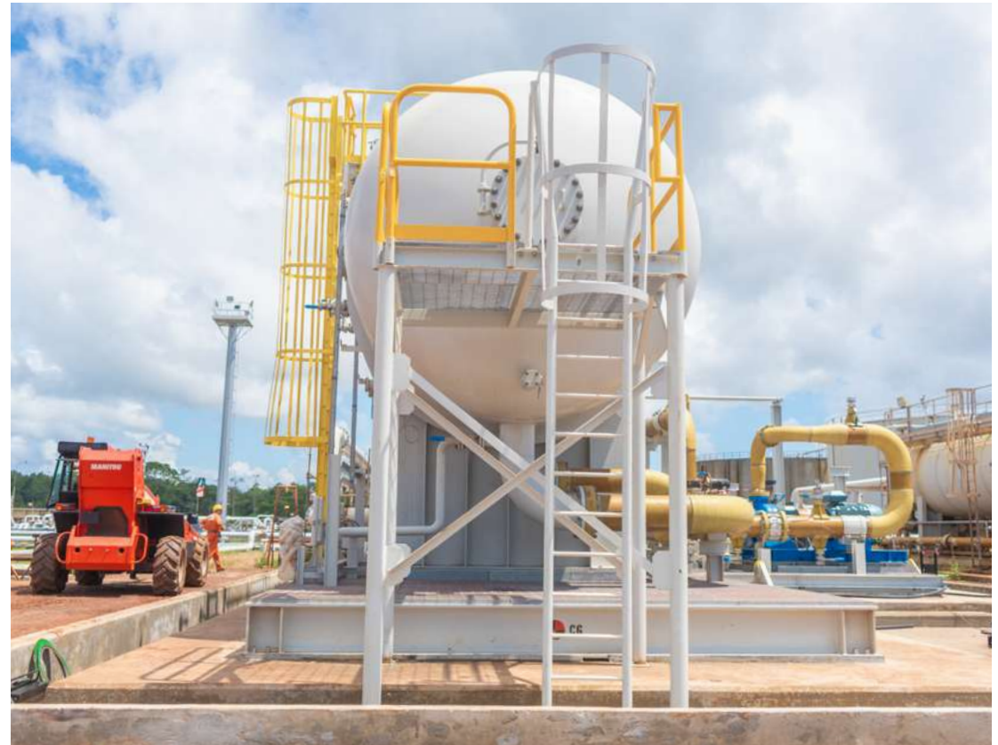
Unité ISF-3 au terminal Gamba en novembre 2023.
